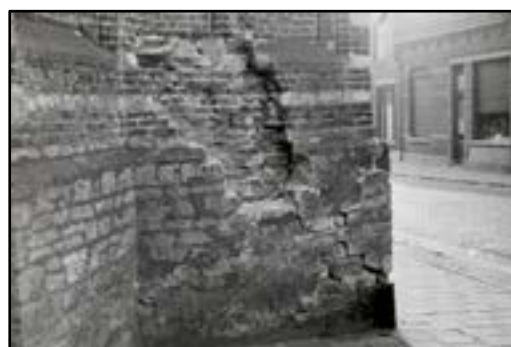
Eén van de vele beschadigingen aan de toren van de St. Laurentiuskerk
